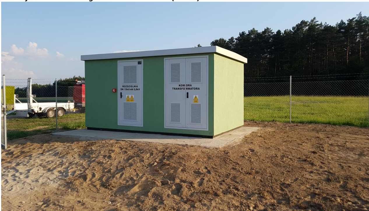
Rysunek 12 Budynek techniczny widziany od strony wejść do rozdzielni i komory transformatora
