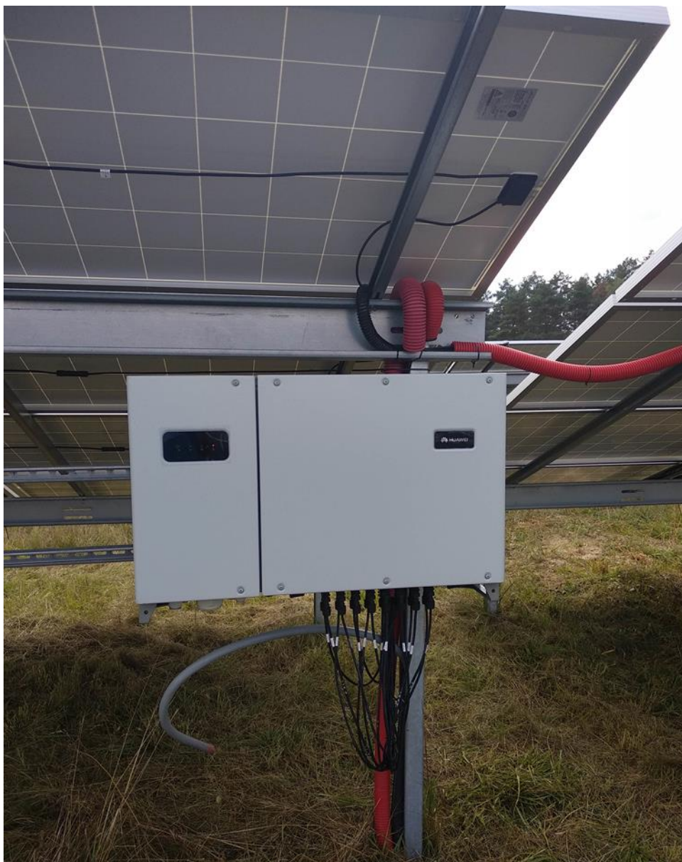
Rysunek 10 Widoczny inwerter zamocowany na konstrukcji nośnej paneli fotowoltaicznych
