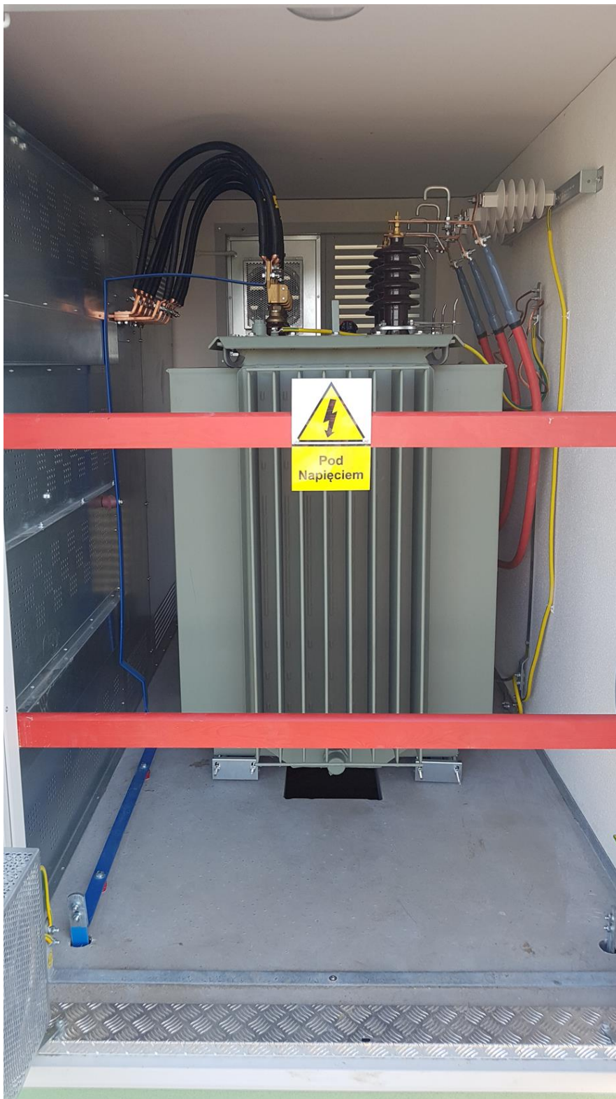
Rysunek 11 Wnętrze stacji transformatorowej
